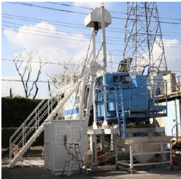
写真2 T-ITANモバイルプラント
