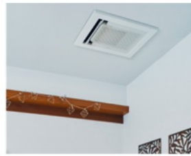
脱衣室のエアコンが自動でON
