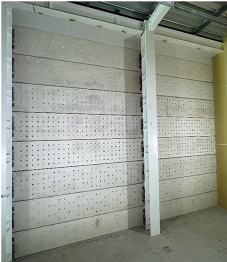
写真1 技術センター内実験施設への設置状況
