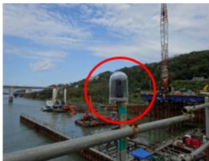
現場から映像を配信している360°カメラ
