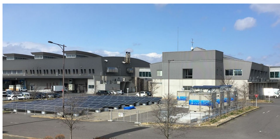
郡山市総合地方卸売市場に導入した実証設備
